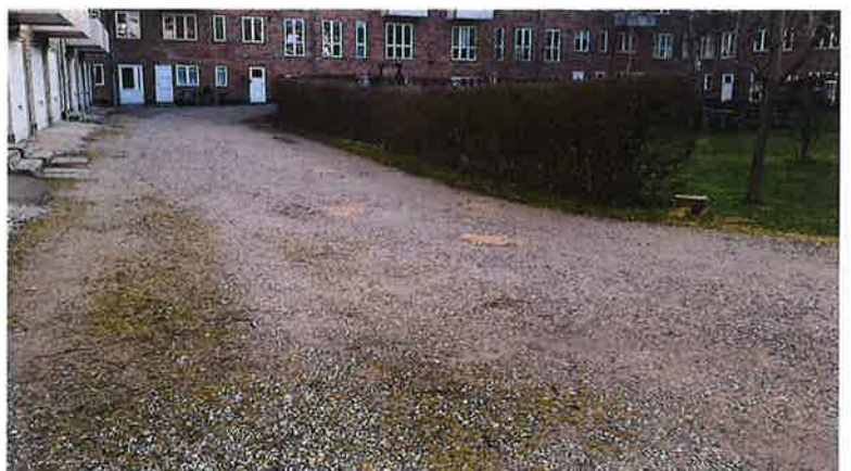
Grusbelægning ved garager ligger lidt lavt.
