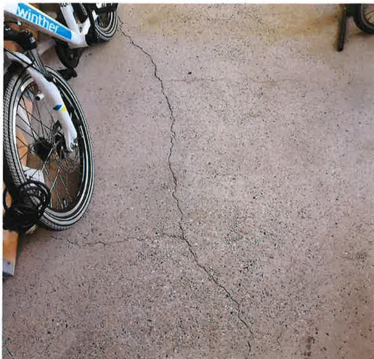
Kældergulv med revner og manglende underlag (hult)
