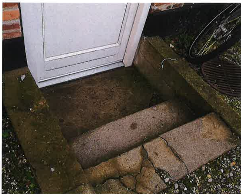
Nedgang ved kælderdoor bør sikres mod vandindtrængen.
