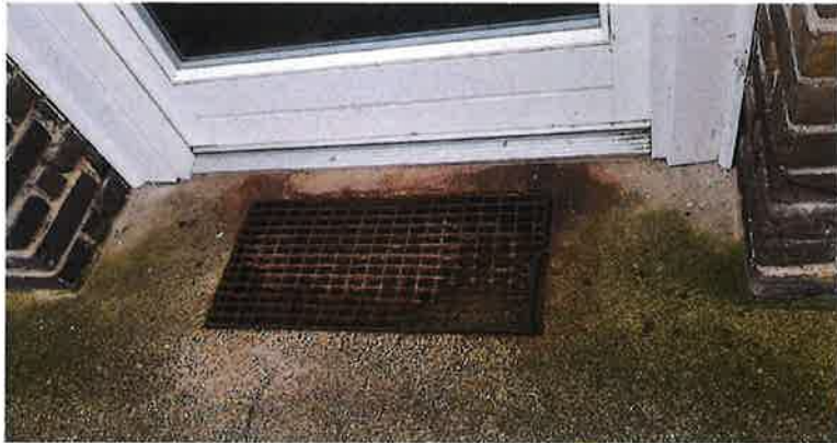
Skraberist rusten og hullet
