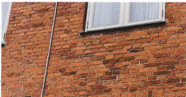
Sætningsrevne under vindue
