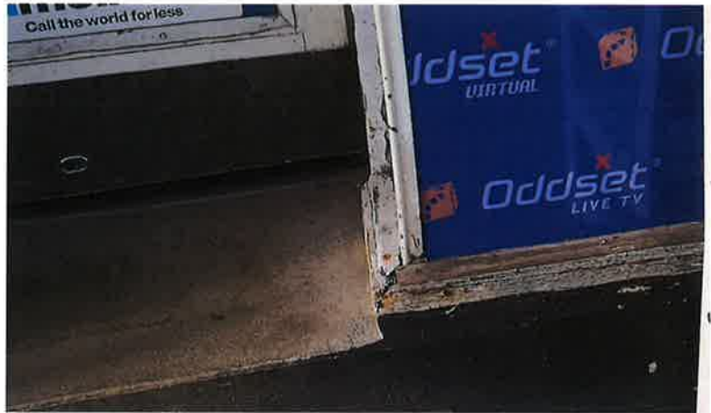
Facadeudsnit med rådne bundglaslister
